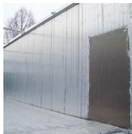
Plaques d'usure sur la paroi intérieure
