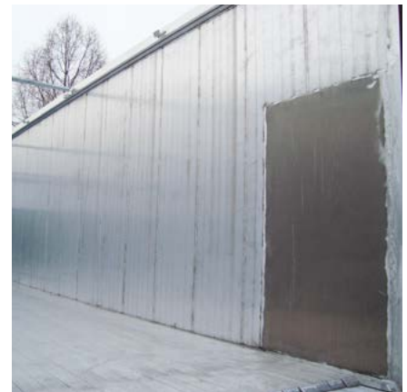
Schleißplatten an der Innenwand
