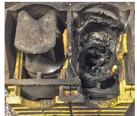
Folge: Durch Feuchtigkeit/schlechten Anschluss kann es an den Anschlüssen des EBS-Modulators zu Verbrennungen kommen.
