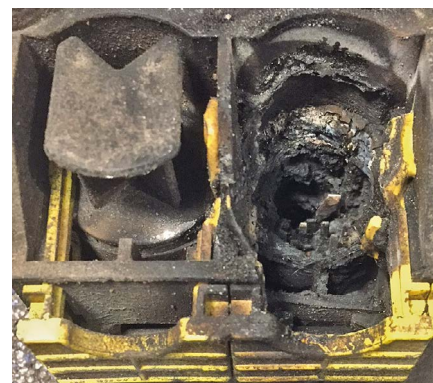
Gevolg: door vocht / slechte aansluiting kan verbranding ontstaan bij de aansluitingen van de EBS-modulator
